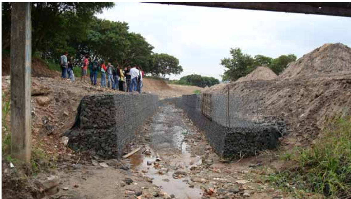
Foto 1. Visita à Praça Carlos Marighela, Campinas, projeto de contenção de boçoroca (2008). Foto: Heraldo Campos
