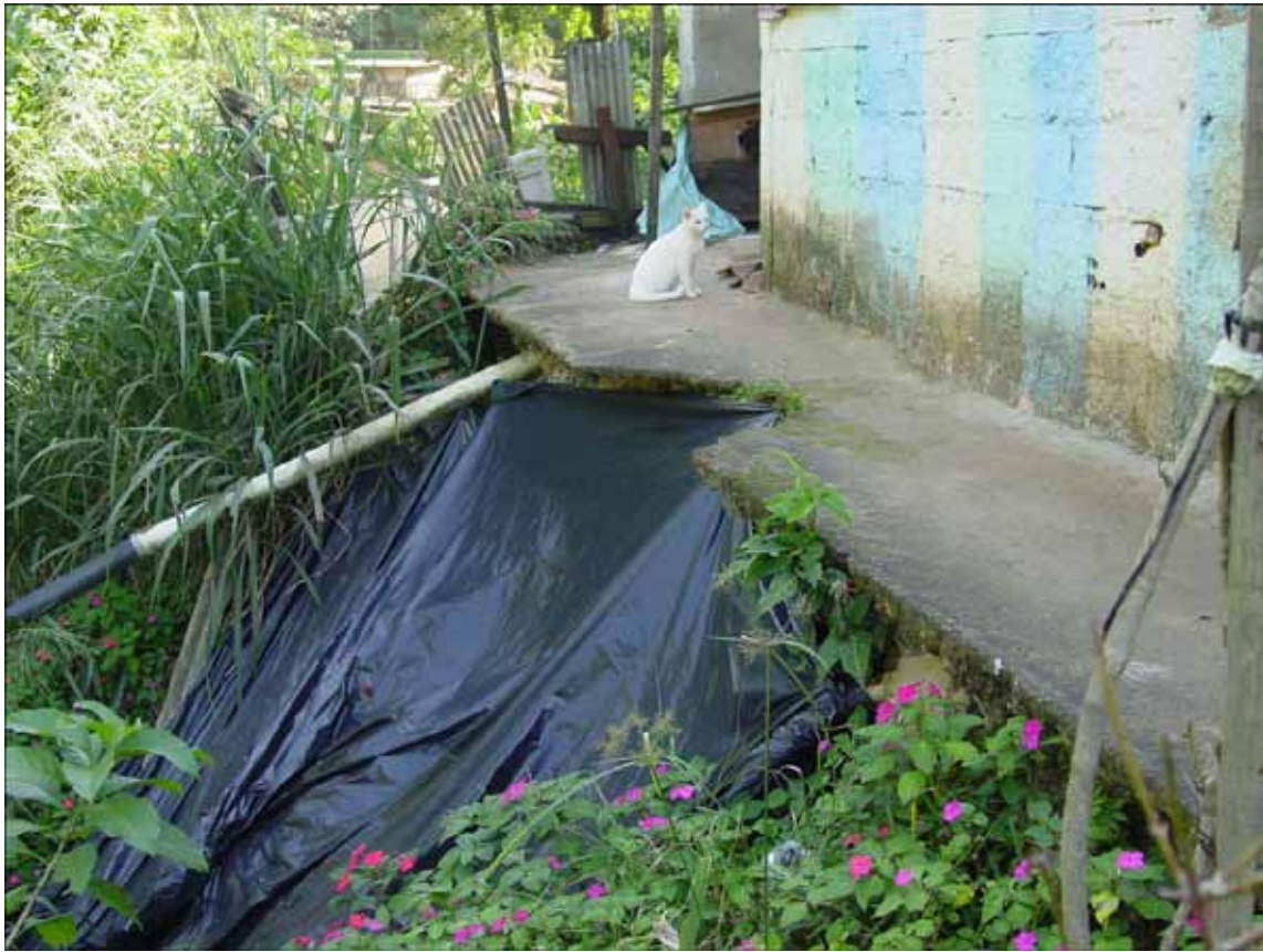
Foto 6. Área com escorregamento sob residência; cobertura de lona para evitar infiltração de água, Bairro do Grotão, Cubatão. Foto: Rogério Marcon
